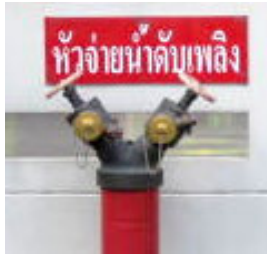
หัวจ่ายน้ำดับเพลิง (fire hydrant)
