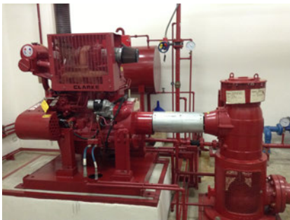
เครื่องสูบน้ำดับเพลิง (Fire Pump)
