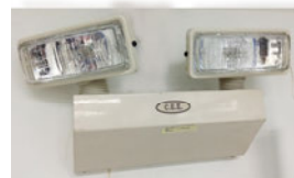
ป้ายบอกทางหนีไฟ (fire exit sign) และ โคมไฟฉุกเฉิน (emergency light)
