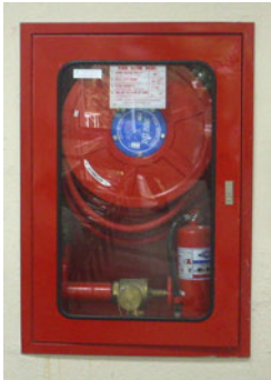
ตู้อุปกรณ์สายส่งน้ำดับเพลิง (fire hose cabinet)
