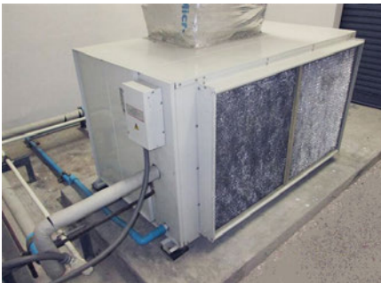
เครื่องส่งลมเย็นขนาดใหญ่แบบเดินท่อลม (Air Handling Unit - AHU)
