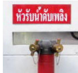
หัวรับน้ำดับเพลิง (fire department connection)
