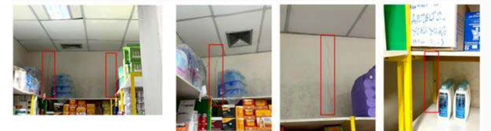
รอยแตกร้าวแนวยาวบริเวณห้องคลังยาชั้น 1
