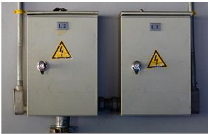
แผงเมนไฟฟ้า
