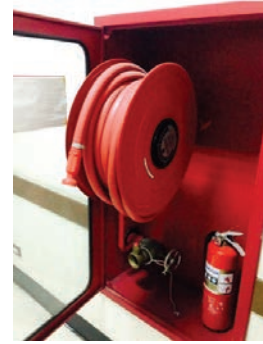
รูปที่ 9 ตู้ดับเพลิงที่มีสายส่งน้ำแบบขมวด
