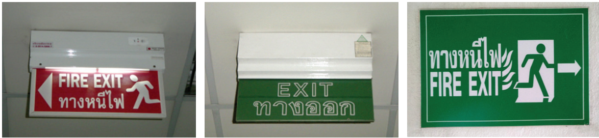
รูปที่ 45 ป้ายบอกทางหนีไฟ
